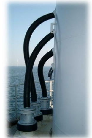
Kabeleinführungen an Offshore-WEA
