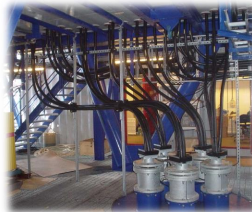
Kabelaufhängung auf Transformatorplattform
