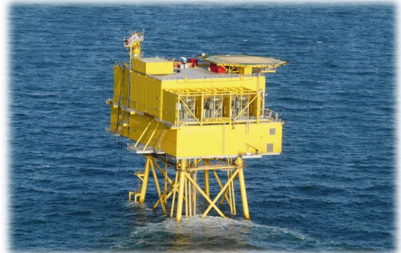
Offshore Umspannstation und Konverter BorWin alpha
