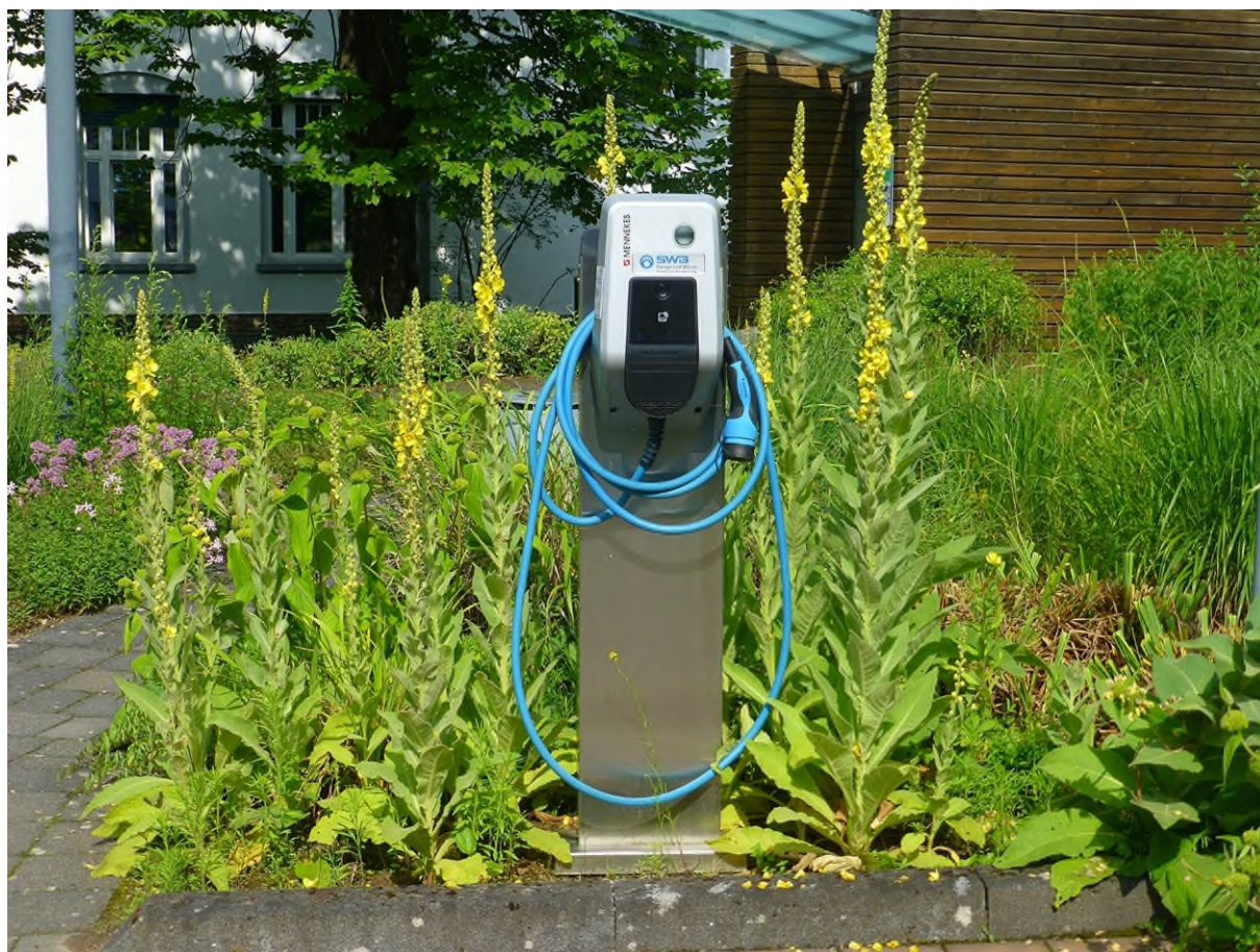
Abb. 11: Eine der drei E-Tanksäulen neben dem Eingangsbereich am BfN-Hauptsitz (Foto Hofbauer 2021)
