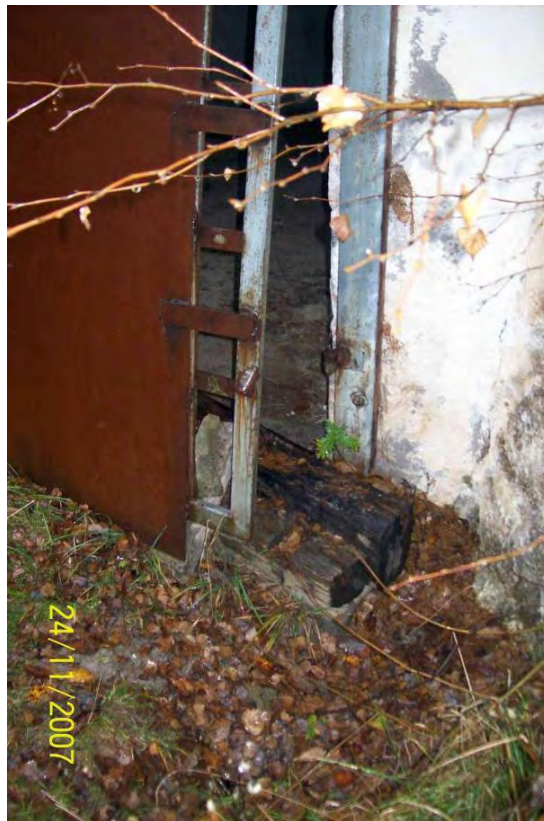
Abb. 23: Altendorf – Schrottsammler öffnen auch massive Vergitterungen - notfalls mit dem Trennschleifer.
