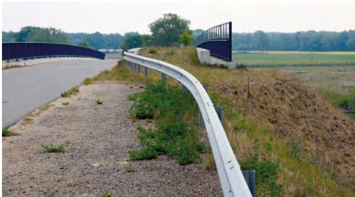
Abb. 48: Nutzung von Grünstreifenbau- werken (2)
